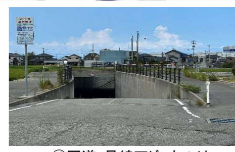
⑩国道8号線下トンネルは 人通りが少なく危険
